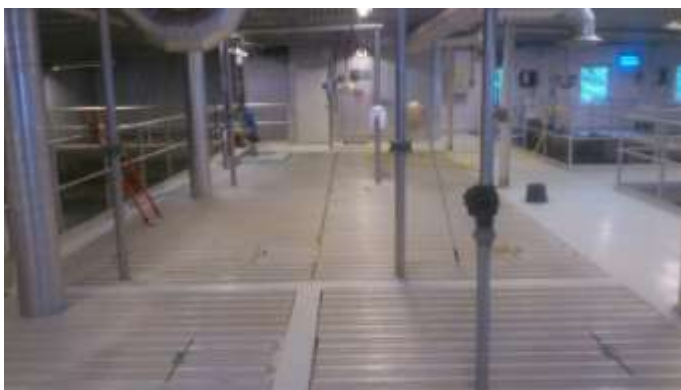
Bassänghallen med luftningsbassängerna
